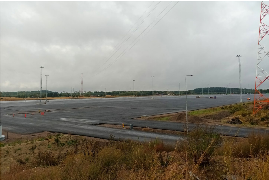
Kuva 2. Kouvolan RRT-alue otetaan käyttöön vuonna 2023. Syksyllä 2022 otetussa kuvassa asfaltoitu kenttä, valaistus ja lastausraide alkavat olla valmiina. (Kuva: Tiina Poikolainen)
