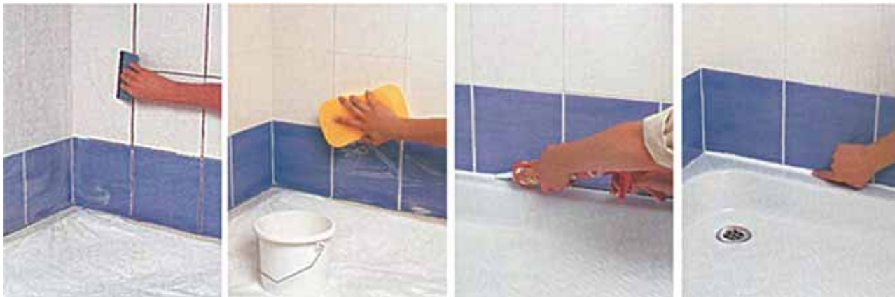
Рис. 100. Затирка швов облицовки и покрытие силиконом шва между душевым поддоном и облицовкой
