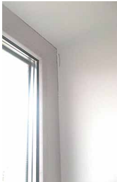
Рис. 57. Трещина в штукатурном откосе сделанном без силиконовой прослойки
