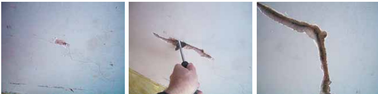
Обнаружить и расширить трещины
