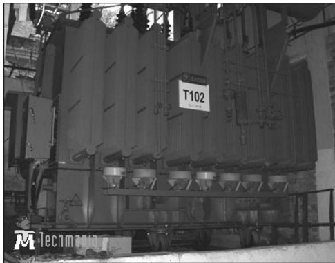
Transformátor ve Vranovské elektrárně
