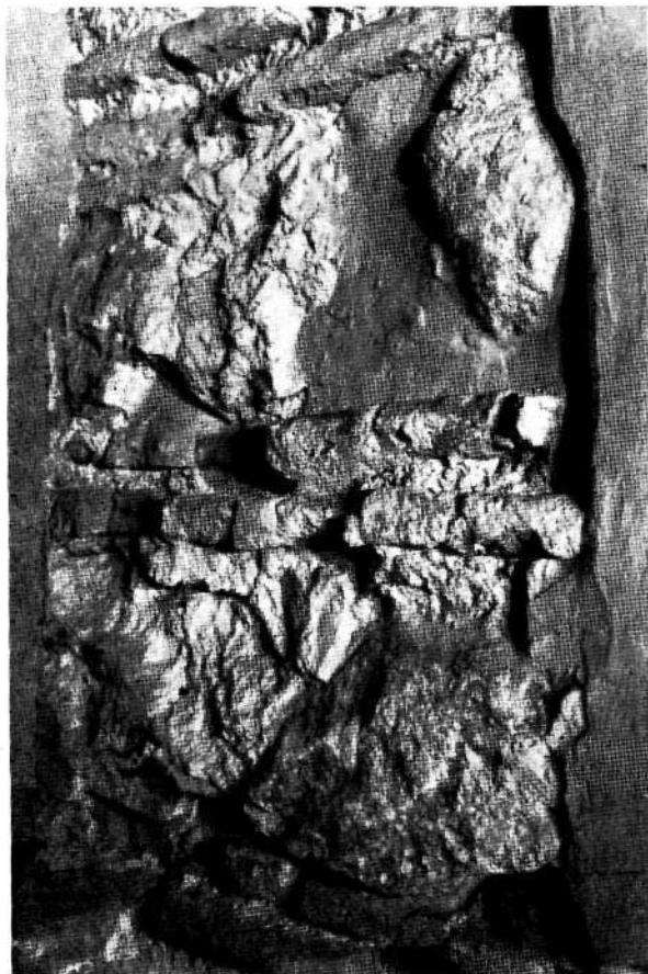
Рис. 6. Фрагмент столба-прикладки, подпирающего зенит аркбутана возле Северной башни. Кладка смешанного типа.
