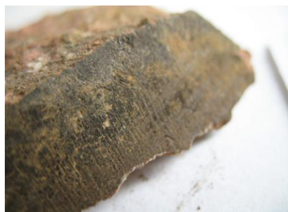
Чёрная плёнка загрязнений и биопоражений гранита внутри вазы (А.Б.)
