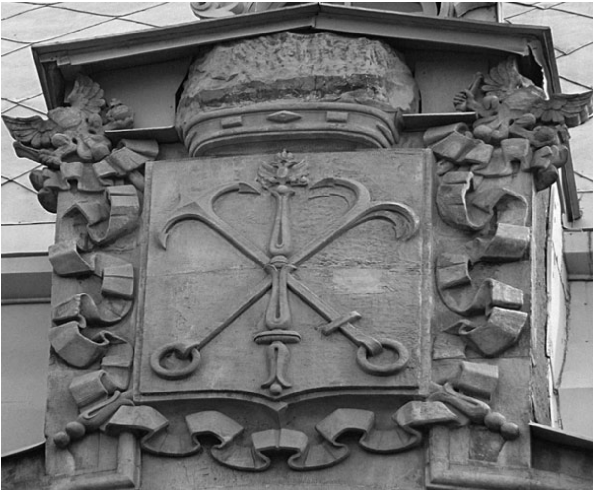
Серый песчаник и керамика в оформлении фасада дома 22 на Б. Морской улице
