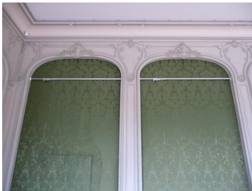
Fig.18 : Nicolas Pineau : Boiseries de la galerie du château d'Asnières, 1750 (cl. Ph. Cachau).
