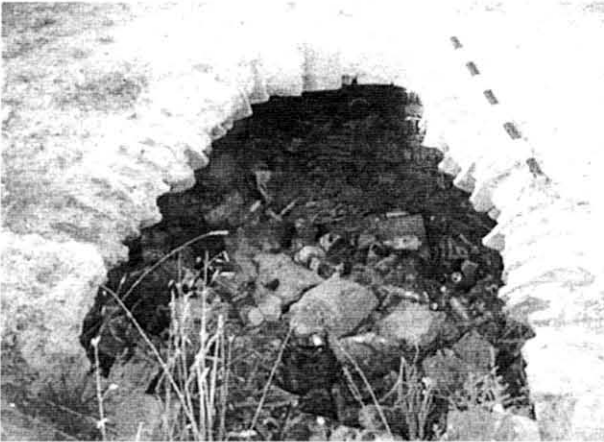
Рис. 4. Состояние склепа на момент проведения консервации (2005 г.).
