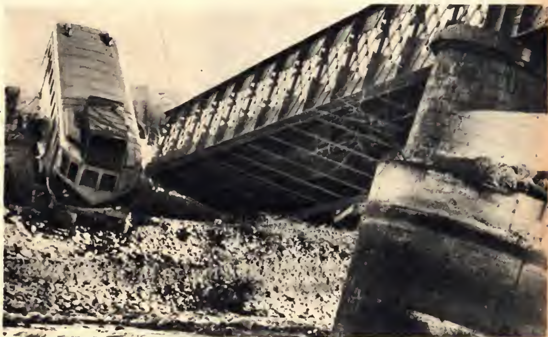
La piena del torrente Dranse ha fatto crollare il pilone centrale del ponte lungo la strada Evian-Lione. Un autopulman che stava per attraversarlo si è trovato improvvisamente dinanzi al vuoto: la pronta frenata del conducente ha però trattenuto il grosso veicolo sulla scarpata, evitando la catastrofe.
