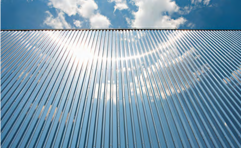
Für die Fassade dieses Industriegebäudes in Siemianowice Śląskie, Polen, wurde der Werkstoff 1.4526 in der blankgeglühten Ausführung 2R gewählt, welche die Selbstreinigung begünstigt. Foto: Aperam/ A. Zekri
