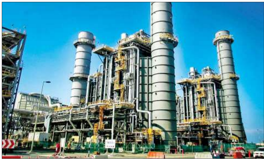
BHI의 배열회수보일러(HRSG)가 설치된 아랍에미리트(UAE) 에말복합화력발전소.
