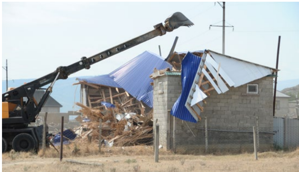
Снос незаконно возведенного строения
