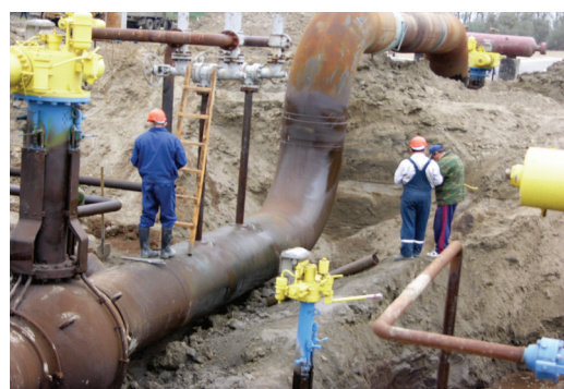
Сентябрь 2005 года. Строительство узла редуцирования газа у с. Кохановка Кизлярского района РД на МГ «Кумли – Аксай»
