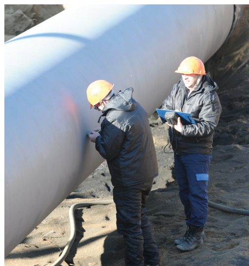
Диагностическое обследование трубопровода на наличие недопустимых поверхностных и внутренних дефектов
