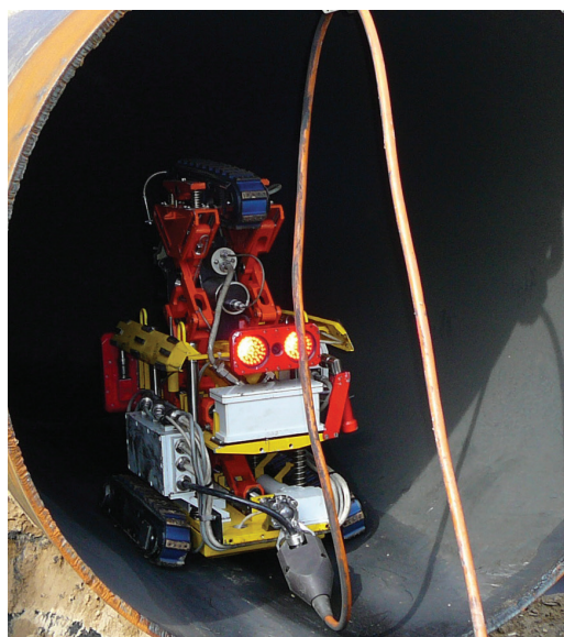
Визуализация состояния внутренней поверхности стенки трубопровода на наличие дефектов с помощью робота, снабженного видеокамерой
