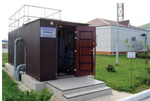
Комплексная установка очистки сточных вод в Махачкалинском ЛПУМГ
