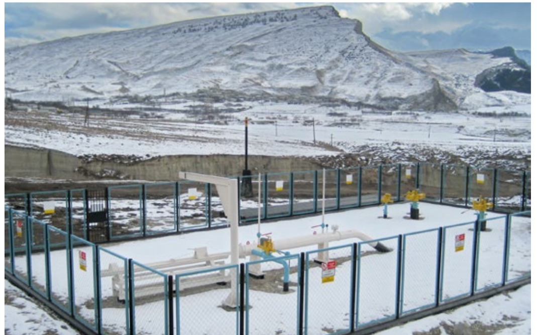
Узел запуска очистного устройства на ГО «Ботлих»
