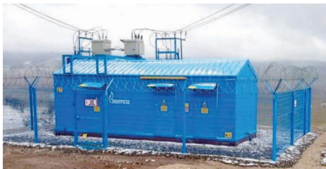
Блочное-комплектное устройство с оборудованием телемеханики, энергоснабжения и ЭХЗ на ГО «Чапаево»
