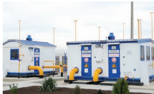
Газораспределительная станция «Чапаяев»
