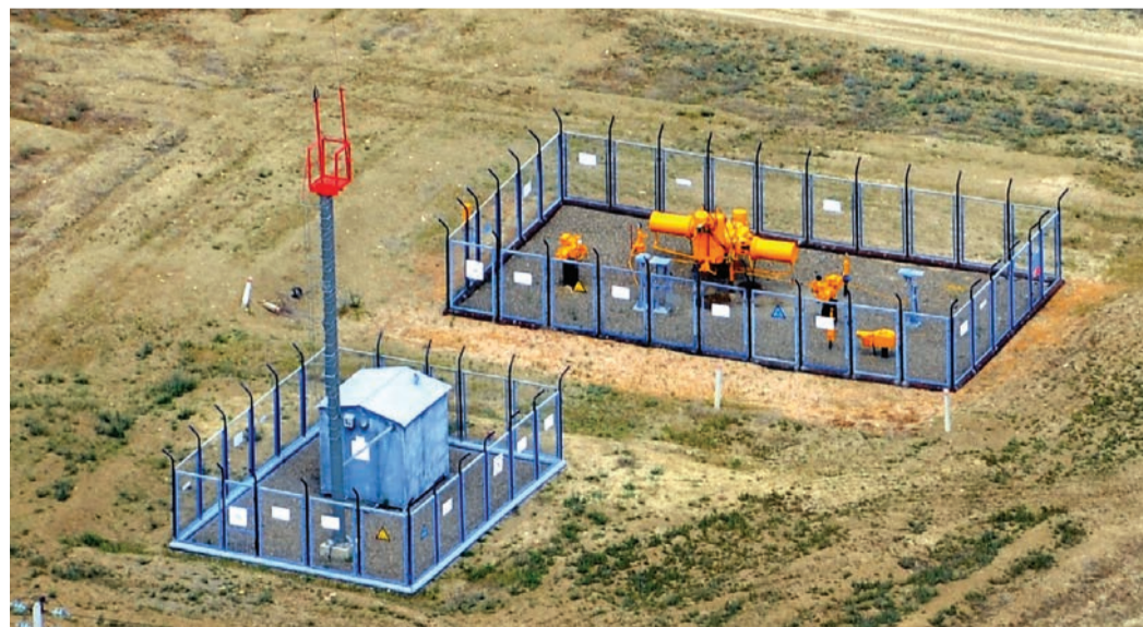
Крановая площадка и контролируемый пункт телемеханики с мачтой связи на 465 км МГ «Моздок – Казимагомед»
