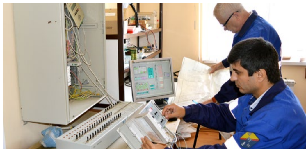
Специалисты Службы автоматизации и метрологического обеспечения настраивают блок пульта автоматизированного управления крана (ПАУК)
