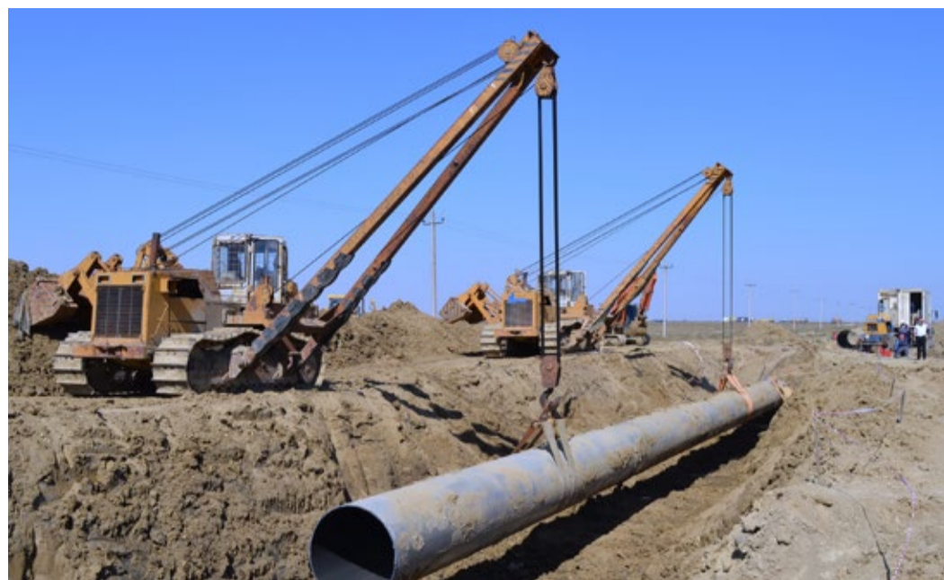
В ходе масштабных огневых работ на участке 729–810 км магистрального газопровода «Макап – Северный Кавказ» внутренним диаметром 1400 мм устранены ранее выявленные дефекты, а также к действующему магистральному газопроводу подключен капитально отремонтированный участок 782–784,1 км
