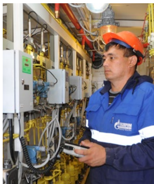
Учет показателей газоизмерительного оборудования на ГИС «Кумли»
