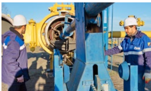
ДЕФЕКТОСКОП РАССКАЖЕТ О ТРУБЕ Проведен комплекс работ по внутритрубной дефектоскопии Стр. 3
