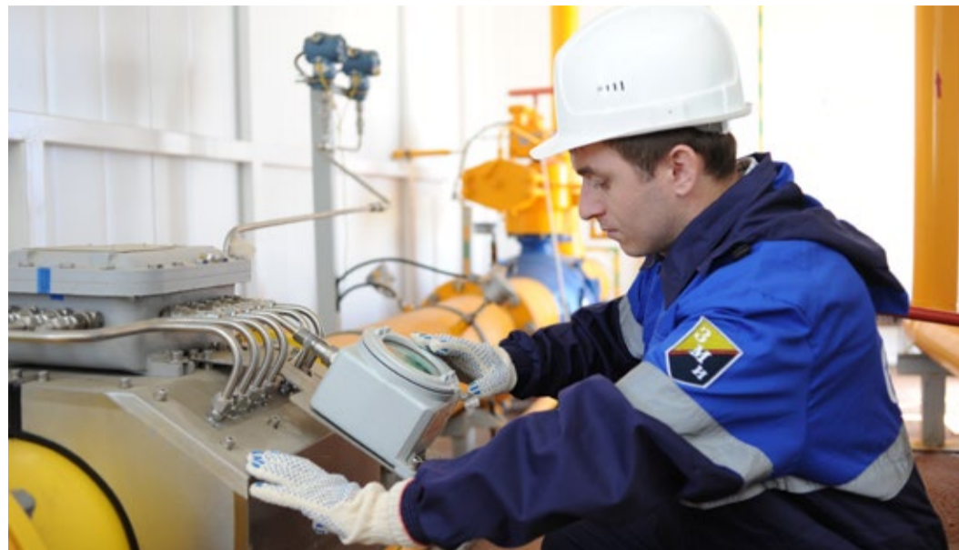
Узел измерения расхода газа на АГРС «Чапаево»
