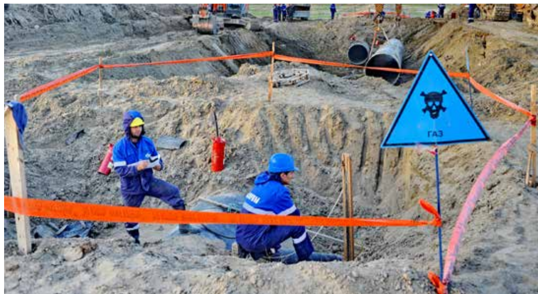
Контроль за состоянием и давлением внутри герметизирующего отключающего устройства
