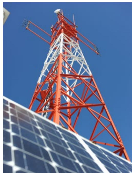
Использование солнечных электрогенераторов на ПРС «Кырк»
