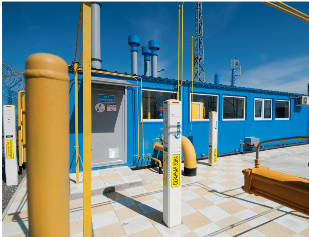
Газораспределительная станция «Южно-Сухокумск»
