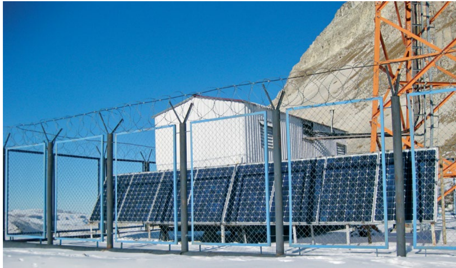
Солнечные электростанции на промежуточной радиорелейной станции «Андийские ворота»
