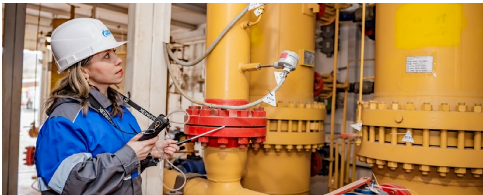
Измерение газоанализатором ФП-22 объемной доли метана в воздухе на фланцевом соединении запорно-регулирующей арматуры
