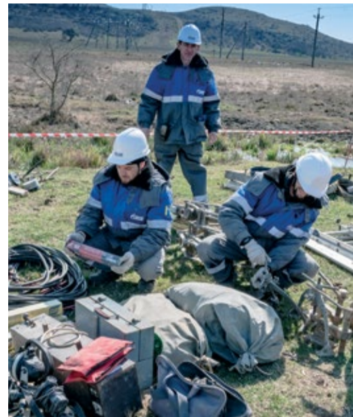
Прибытие аварийной бригады Избербашского ЛПУМГ к месту аварии
