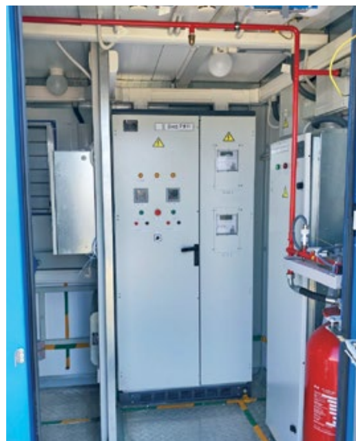
Внутреннее оборудование блок-контейнера электроснабжения
