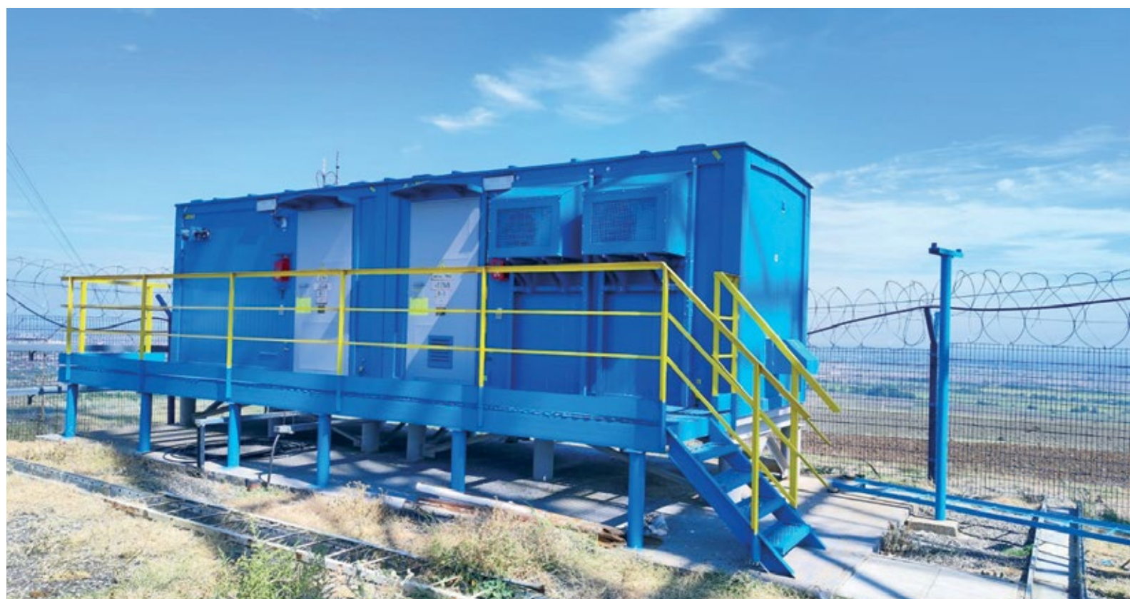
Блок-контейнер электроснабжения на ПРС «Кизилюрт»
