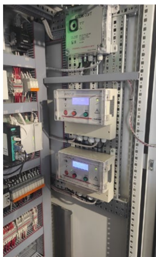
Шкаф автоматики подогревателя газа ГРС «Ленинаул»
