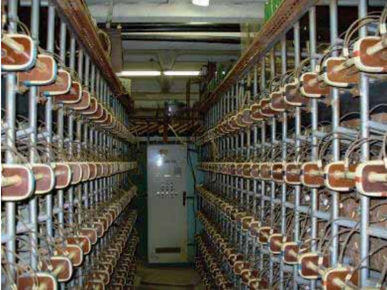
Рис. 9.65. Стеллажи конденсаторной батареи
