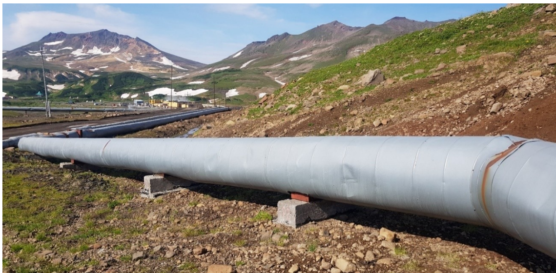
Рис. 197. Трубопроводы пароводяной смеси на Мутновском месторождении (Камчатка)
