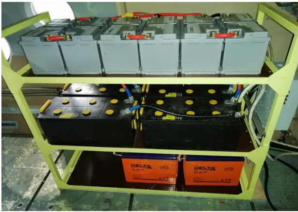
Комплекс (ПСПЭК) на борту ЛЛ
