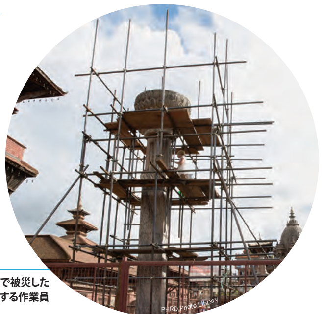
支援前：地震で被災した建造物
