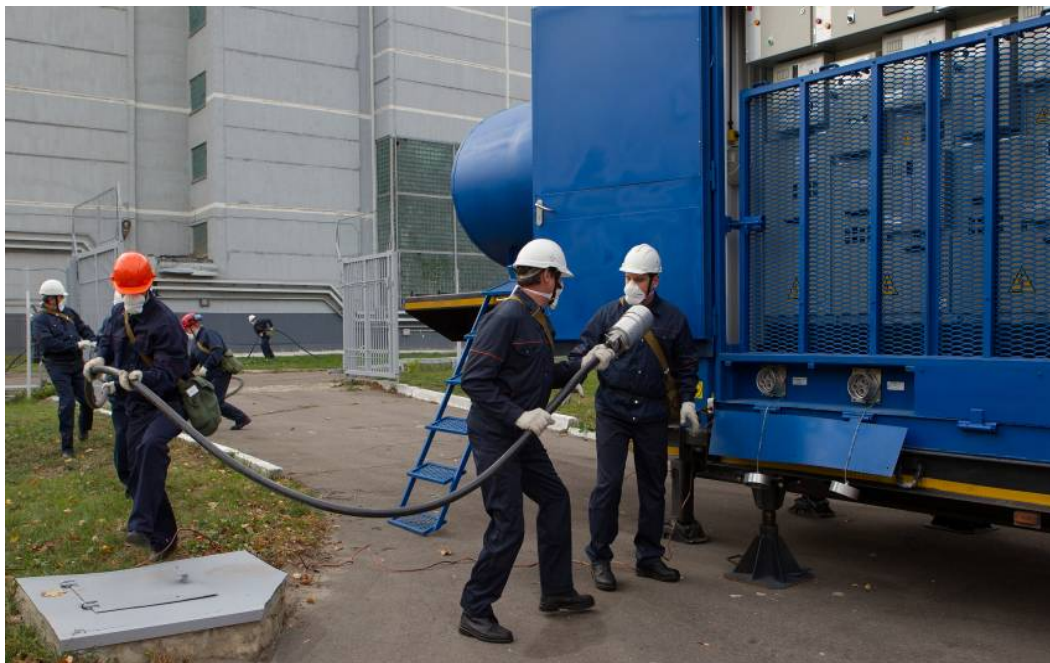
Рисунок 16.5. Комплексные противоаварийные учения на Ленинградской АЭС (2015 г.). Отработка подключения передвижной дизель-генераторной установки
