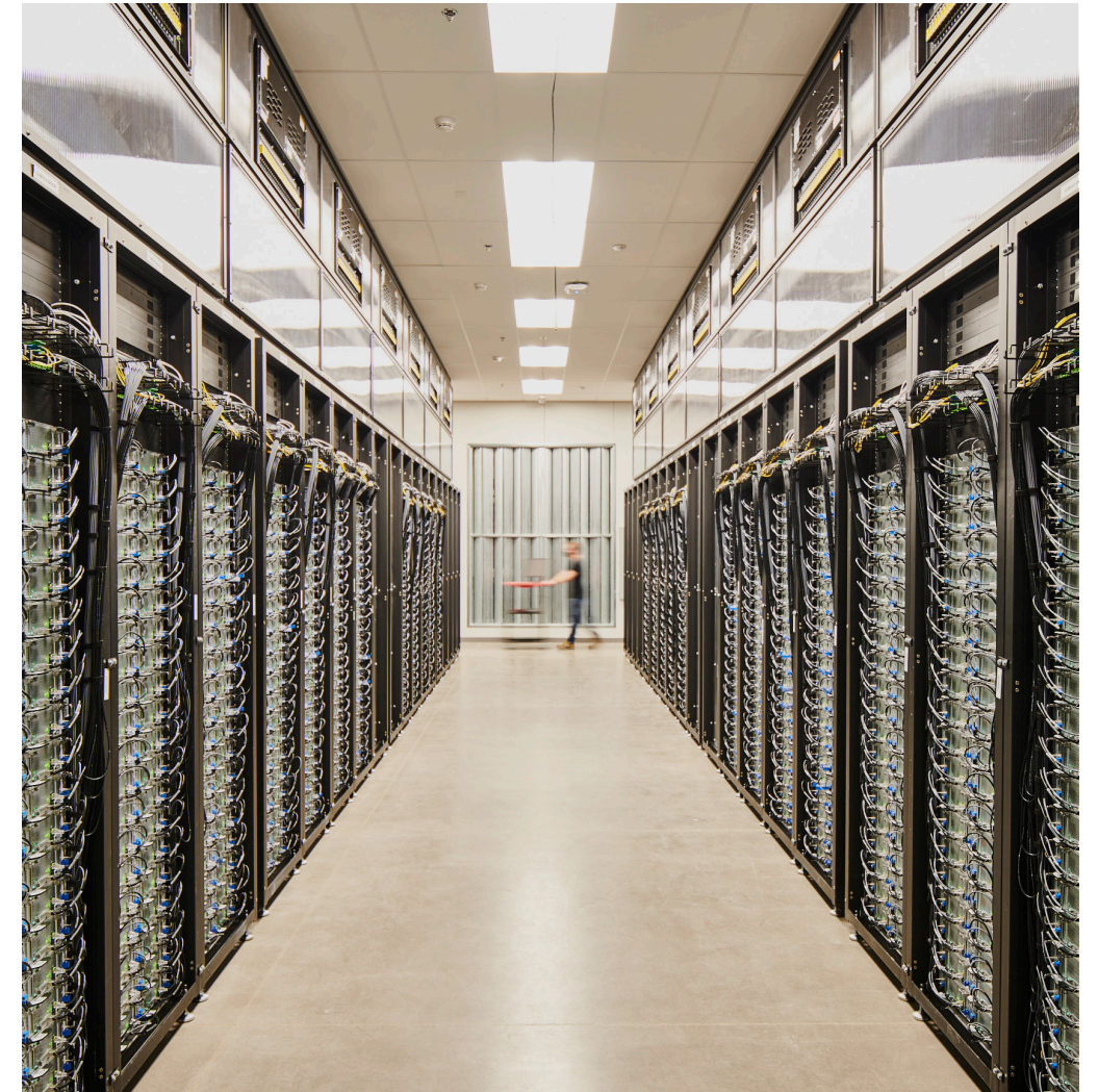
Le data center d'Apple de Reno, ouvert en 2012, profite du climat doux en refroidissant ses serveurs avec de l'air extérieur chaque fois que possible.
