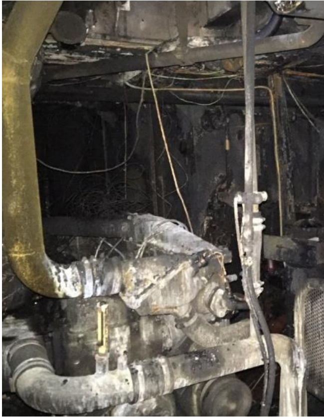
Abbildung 7 Brandherd Luftansaugung Antriebsmaschine
