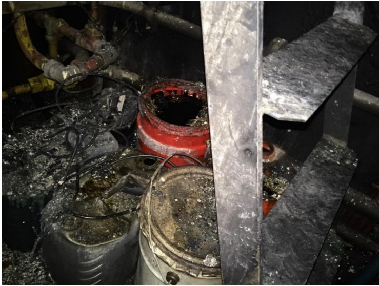
Abbildung 8 Lagerung brennbarer Flüssigkeiten unterhalb der Einstiegsleiter
