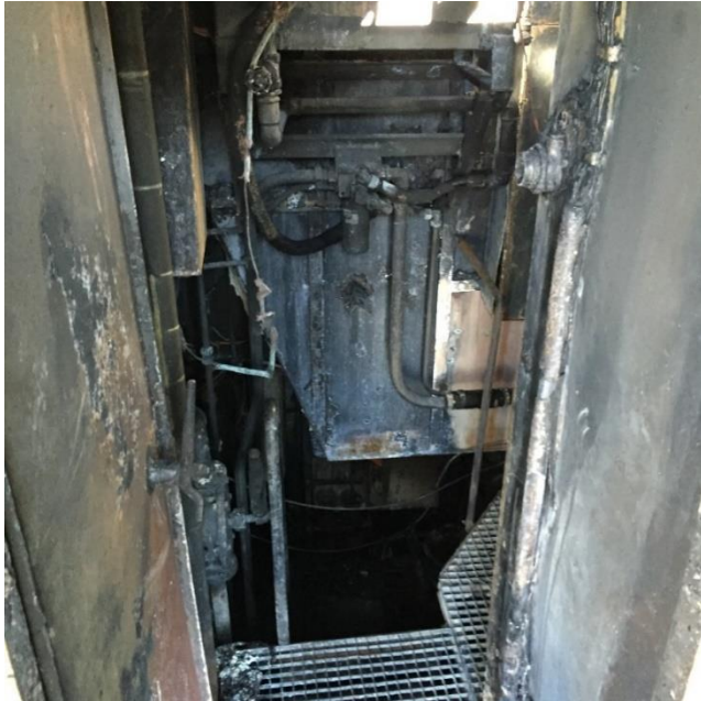
Abbildung 5 Einstieg in den Maschinenraum
