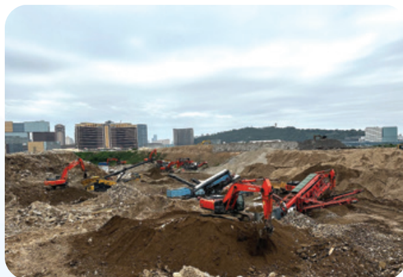
流動式惰性拆建物料篩選設施
