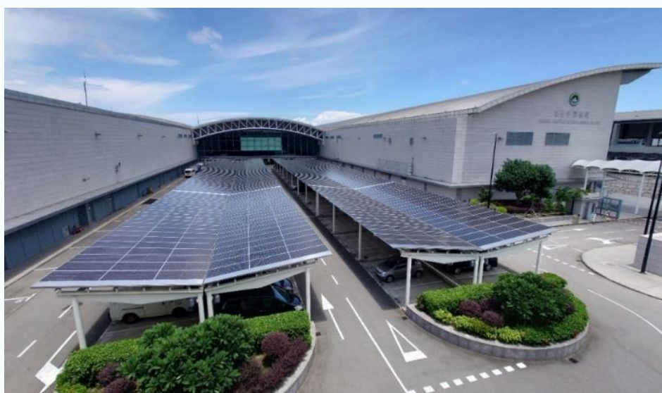
Figura 7 Sistema de produção de electricidade a energia solar fotovoltaica no parque de estacionamento da Ponte-Cais do Pac On
