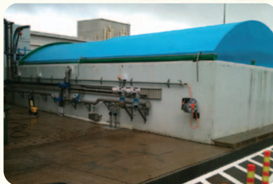
Sistema de recepção de óleos e gorduras e águas residuais da Estação de Tratamento de Águas Residuais de Coloane
