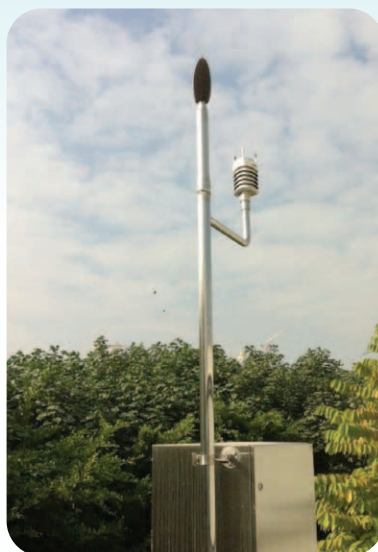
生態保護區之噪聲監測站
