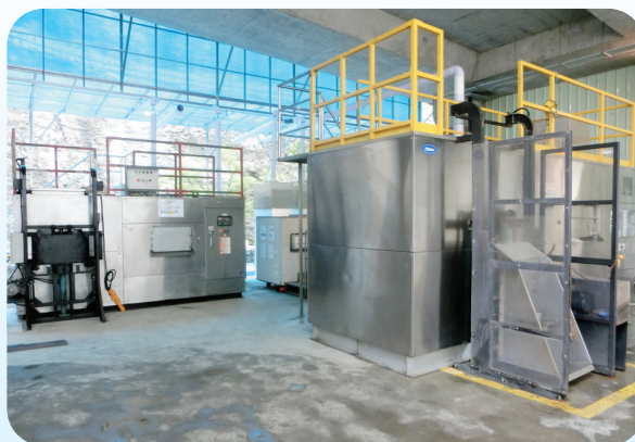
Equipamentos de tratamento de resíduos de cozinha instalados na Central de Incineração de Resíduos Sólidos de Macau (CIRSM).
