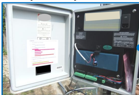
Aparelhos para o processamento de dados e aparelhos de transferência de dados
