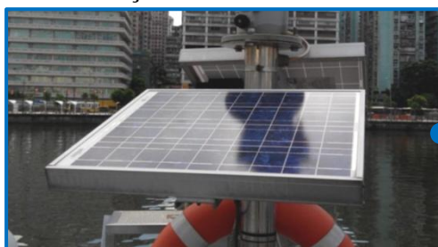
Dispositivo de painéis solares
