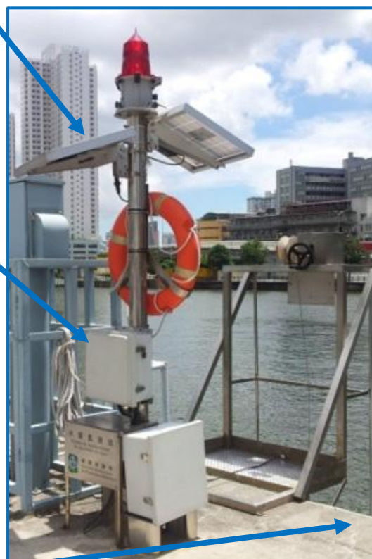
Estação de monitorização automática da qualidade da água
