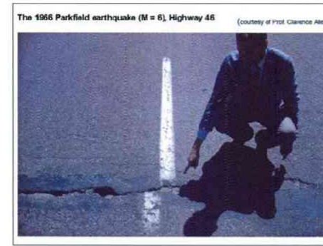
Fig. 5 1966年のカリフォルニアパークフィールド地震によって生じた道路の横ずれ Sideslipped road resulting from the 1966 Parkfield earthquake, California
