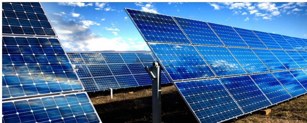
Fot. 1. Panele słoneczne to coraz częstszy widok także na lotniskach, źródło: ze zbiorów autora
