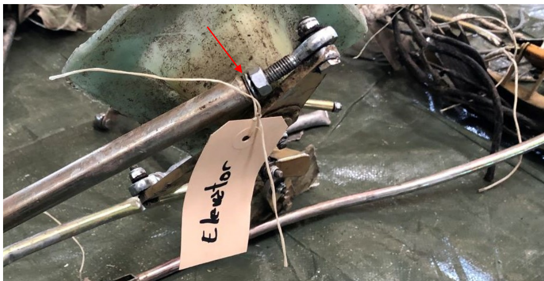
Abbildung 3: Steuergestänge des Höhenruders ( elevator ) mit loser Kontermutter und Fächerscheibe beim Gelenkkopf (roter Pfeil).
