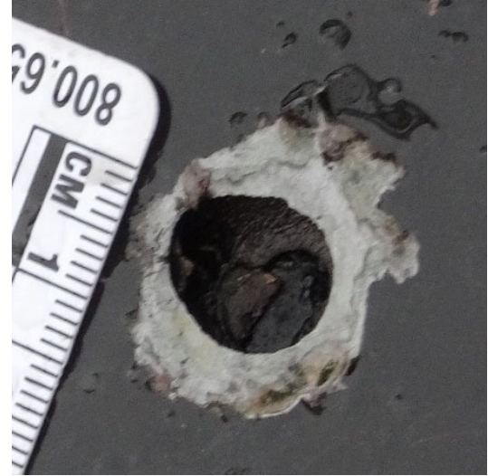
Abbildung 15: Ausprägung der Leckage im Stahlmantel.
