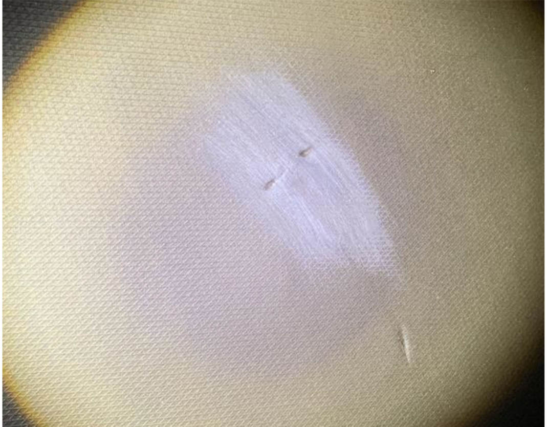
Abbildung 23: Mangel in der Oberfläche der Schutzauskleidung (Kesselwagen 33 84 7829 064-0). Quelle: Ermewa.
