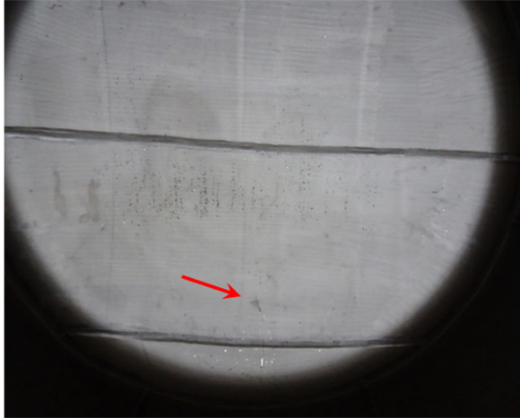
Abbildung 11: Bruchstelle im Tankinnern (roter Pfeil).
