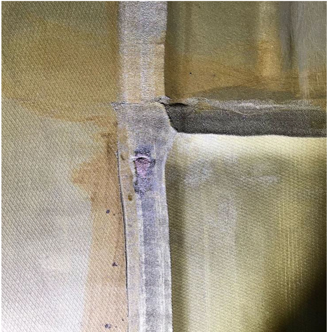
Abbildung 22: Mangel bei der Nahtstelle der Schutzauskleidung (Kesselwagen 33 84 7829 008-7). Quelle: Ermewa.
