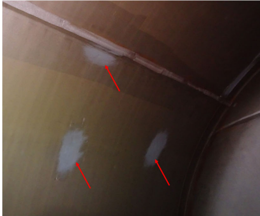
Abbildung 18: Schleifspuren im Tank (rote Pfeile).
