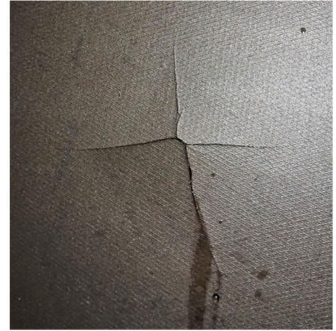
Abbildung 12: Detailaufnahme der kreuzförmigen Bruchstelle in der Schutzauskleidung.
