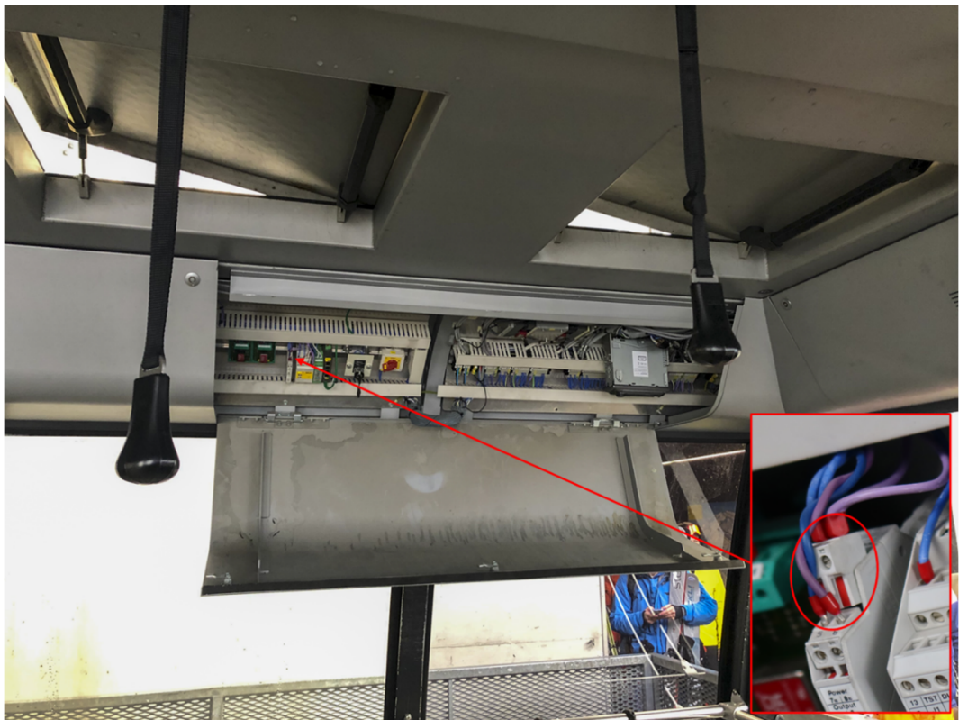
Abbildung 6: Fotografie der Steuerungselektronik der Seilbahnkabine 2 mit Detailaufnahme der herausgezogenen Steckverbindung der Lastmesseinrichtung (rote Markierung).
