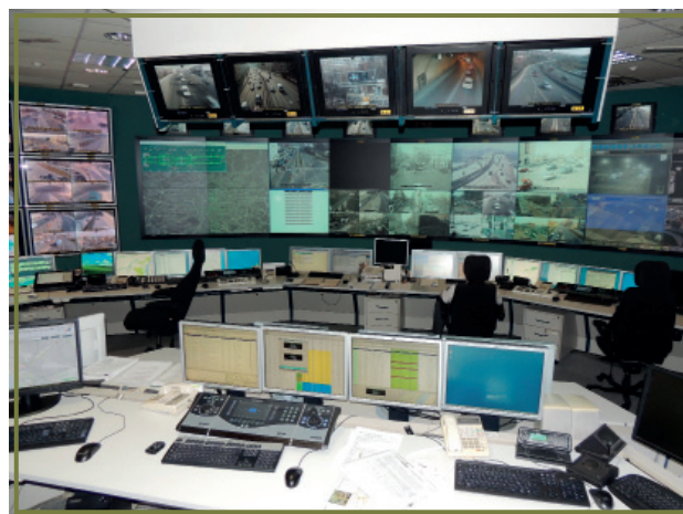
Výstupy z kamer televizního dohledu v HDŘÚ
