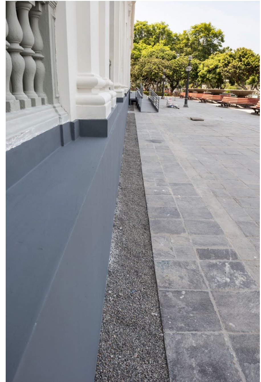
FIG 55 Zanja de ventilación culminada y zócalos pintados en la fachada que da a la Av. Wilson FOTOGRAFÍA: Archivo WMF Perú
