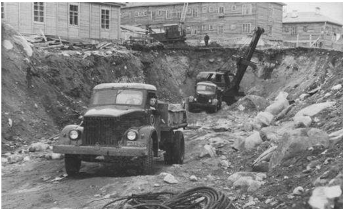
Рытье котлована для нового строительного объекта. 1951 г. ГОКУ ГАМО в г. Кировске. Ф. Р-179. Оп. 12. Д. 247.
