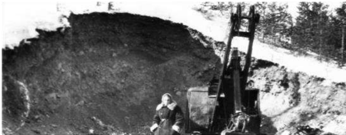
Начало строительства водовода Имандра-ГРЭС. 1957 г. ГОКУ ГАМО в г. Кировске. Ф. Р-42. Оп. 6. Д. 209.
